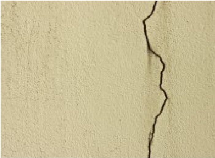
Рисунок 49. Приклад деформації (тріщини) на фасаді будівлі Кабінету Міністрів України між третім і четвертим поверхами. (*Авторське фото)
